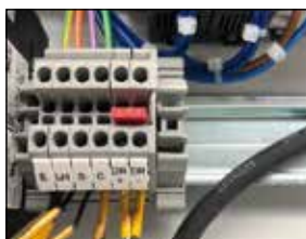
(Geplaatste draadbrug t.b.v. omzeilen deurbeveiliging)
