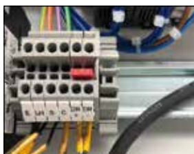
(Geplaatste draadbrug t.b.v. omzeilen deurbeveiliging)
